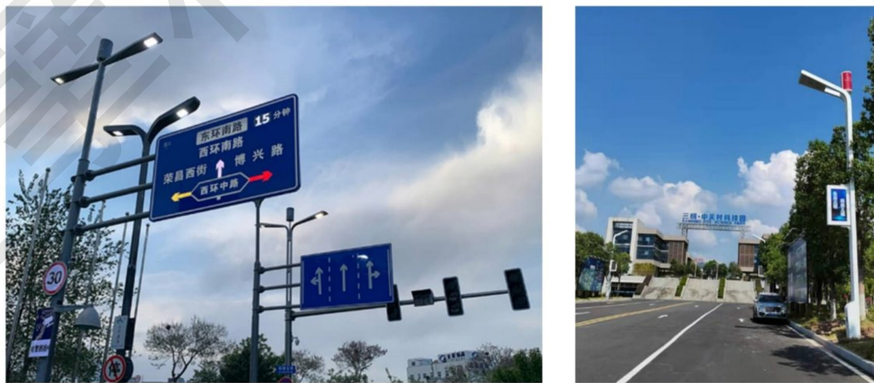
图 2-5 装有透波天线罩的杆载 5G 基站 1
